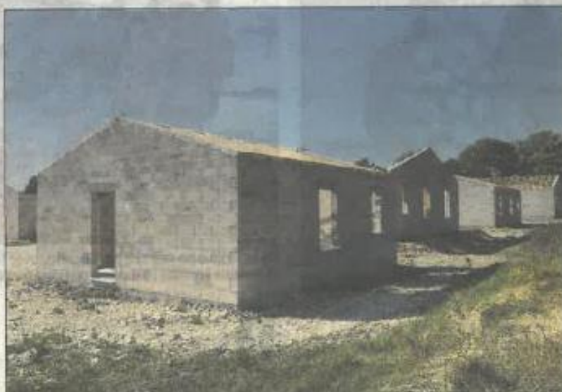
Les dix-sept premiers logements du lotissement « Les cinq sens » sont sortis de terre route de Sigogne, à Luchac.
